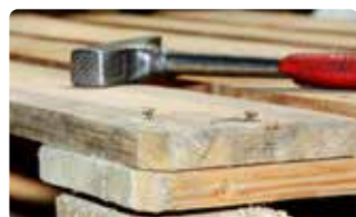
Einschlagen herausstehender Befestigungselemente.
